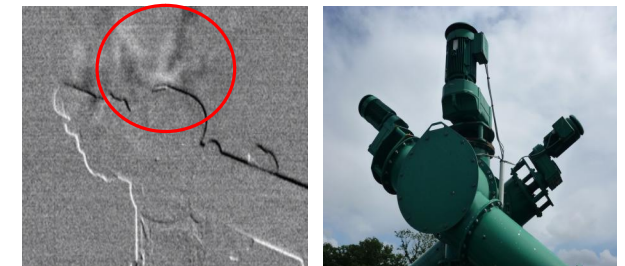
Undichtigkeiten an Wellendurchführung und Flansch.
