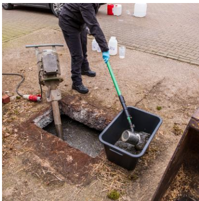
Entnahme einer Teilprobe mit der Teleskopstange aus einer Vorgrube.
